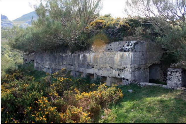
Galería aspillerada con nido de ametralladora semicircular adosado en el puerto de Tarna (Puebla de Lillo, León)
